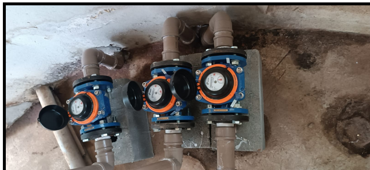
HIDRÔMETROS PARA O ACOMPANHAMENTO DO CONSUMO DIÁRIO DE ÁGUA.
