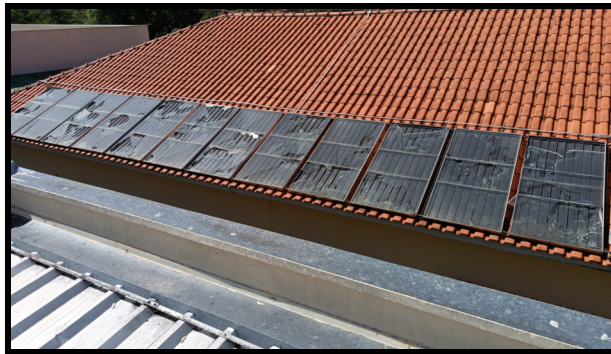
Sistema de aquecimento de água danificado.
