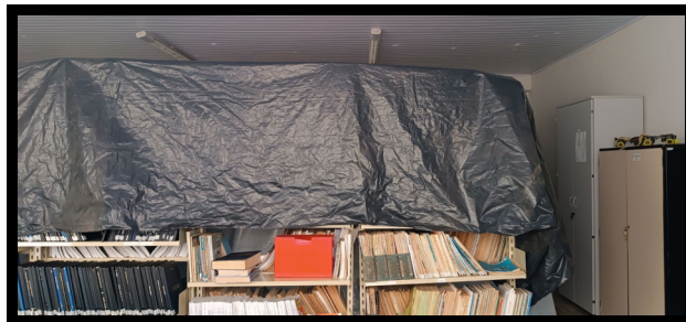
Proteção paliativa para evitar maiores danos.
