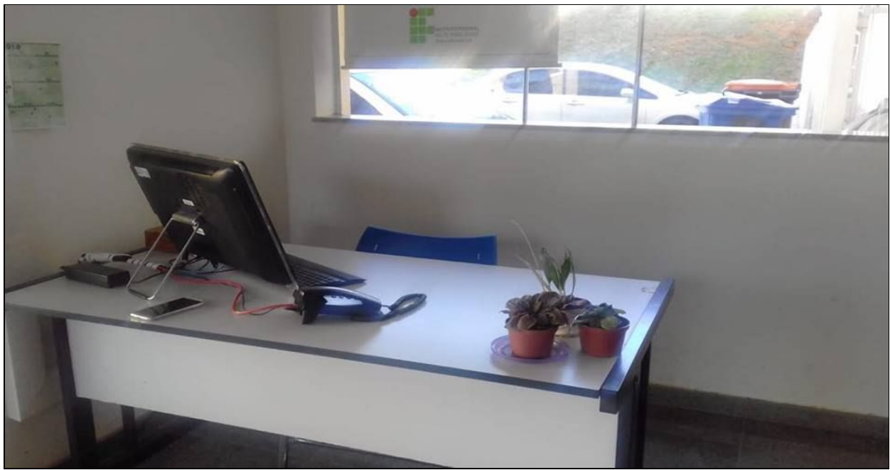
Instalação de telefones e câmeras, já adquiridas, na Moradia Estudantil Feminina, visando a segurança das moradoras.
